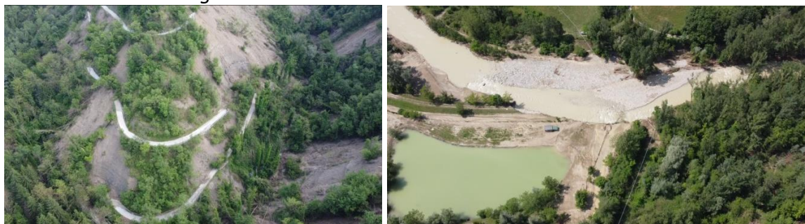
Rilevazione attraverso droni di frane su strada consorziale e erosione dell'argine in destra idraulica in fregio a un laghetto.
