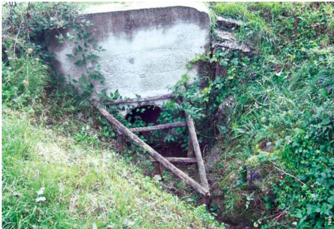
Griglia deflettente selettiva installata all'ingresso di un sottopasso per intercettare i detriti trasportati durante gli eventi di piena
